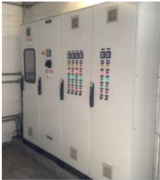
Painel de Automação
