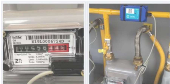
Figura 1 - Instalação do dispositivo de medição remota
