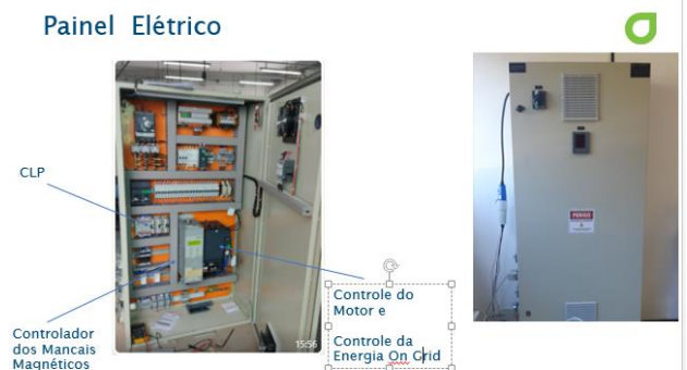
Figura 3 – Painel elétrico para acionamento e controle do sistema de geração
