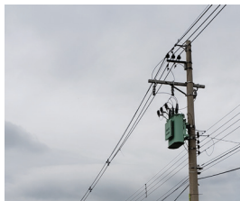
Rede de Distribuição - Rede Compacta
