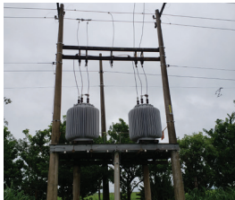
Rede de Distribuição - Regulador de Tensão
