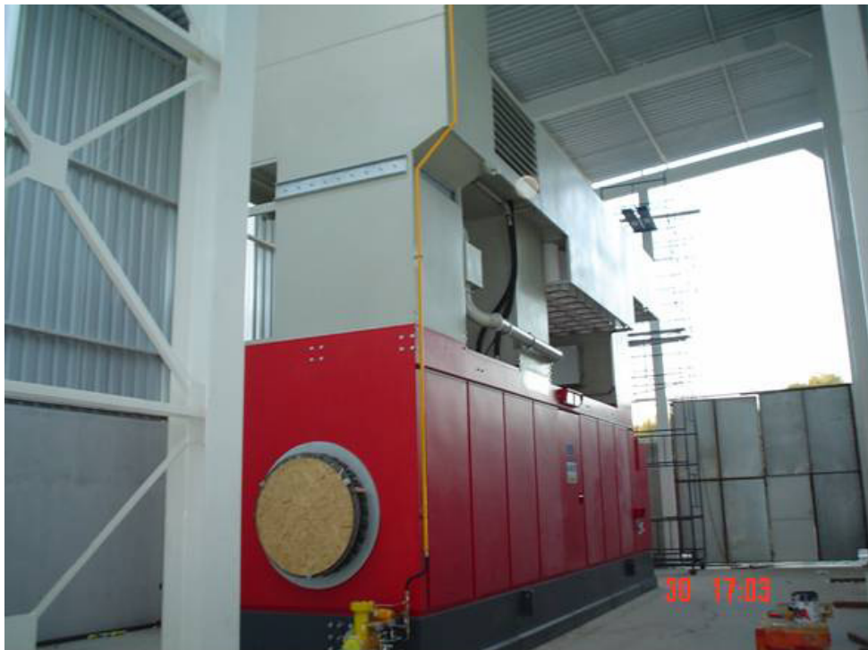
Figura 12– Aspecto do conjunto turbogerador instalado na Pamesa.
