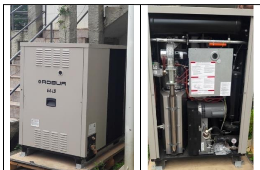
Figura 1 - Unidade de refrigeração por absorção com amônia/água, marca ROBUR e capacidade de 5 TR.
