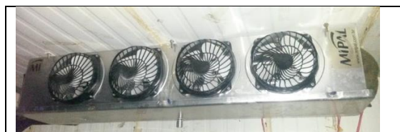
Figura 2 - Fan Coil instalado internamente à câmara frigorífica utilizado para resfriamento com solução alcoólica a baixa temperatura.
