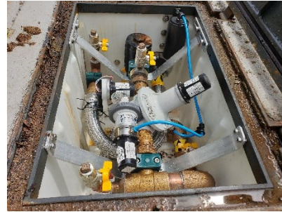
Figura 4- Foto da instalação dos sensores na CRC
