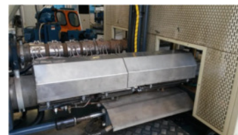
Figura 7: Cobertura Térmica Instalada no Sistema
