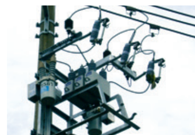
Banco Capacitores CPFL Paulista
