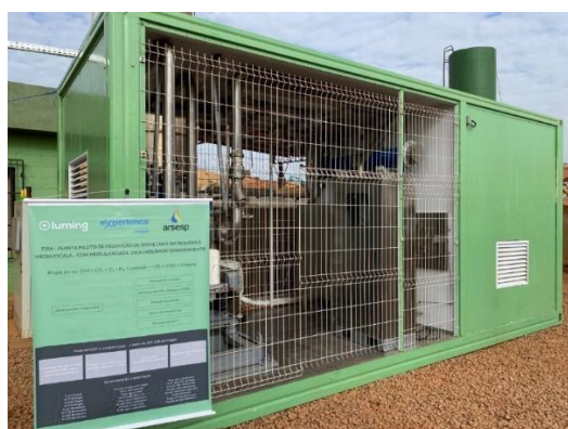
Figura 1 – BioUsina modular, containerizada, em operação.
