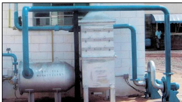
Figura 3 – Sistema de remoção de fluoretos de gases
