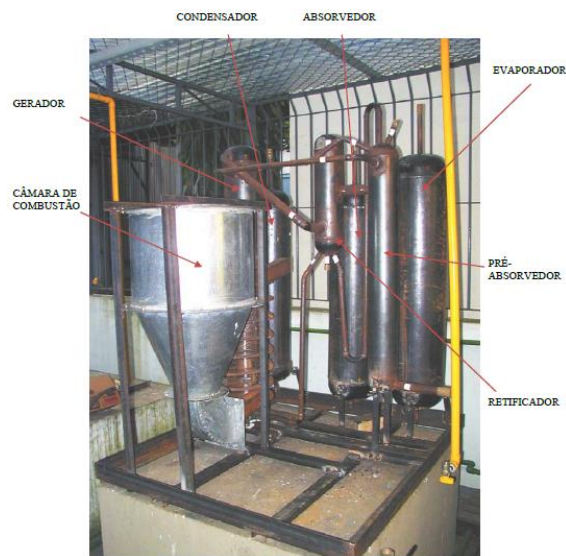
Figura 4 – Condensador, evaporador e absorvedor construídos
