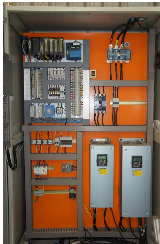
Figura 4 – Interior do Painel Elétrico com PLC, aquisição de dados e inversores de frequência.
